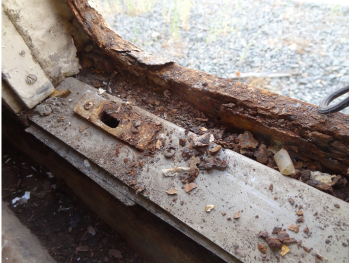
Herrumbre portezuela lado barra
